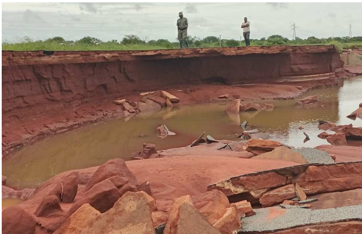
As estradas, incluindo a estrada nacional, foram severamente danificadas pelas cheias.
